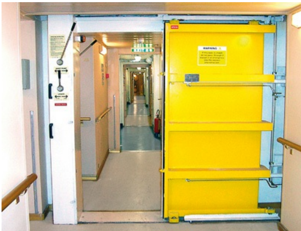
Figur 0160 Vanntett dør bygget etter forskrift av 1992.
